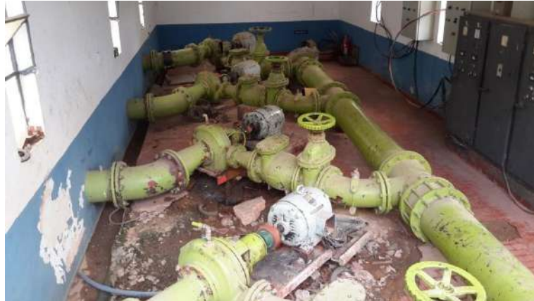
Figura 2: Casa Elevatória de Água Bruta apresentando sérias danificações.
