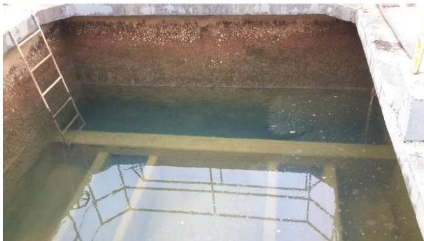
Figura 6: Filtro necessitando de limpeza imediata.
