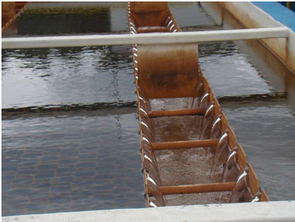
Figura 5: Limpo, sem a presença excessiva de flocos, estando em bom funcionamento.
