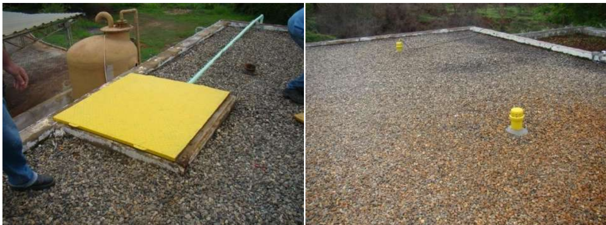
Figura 10: Suspiros e tampas do tanque de contato.
