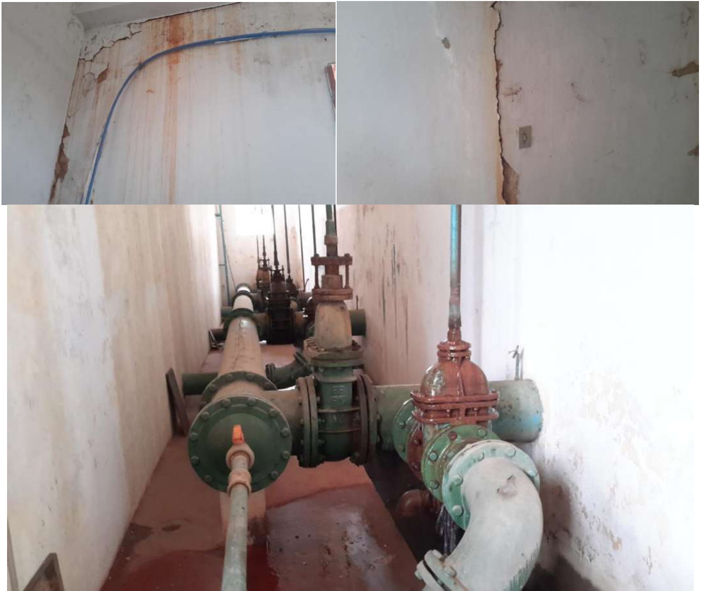
Figura 4: Vazamento constante no registro dos filtros e paredes danificadas com proeminentes rachaduras (local denominado como galeria dos filtros).
