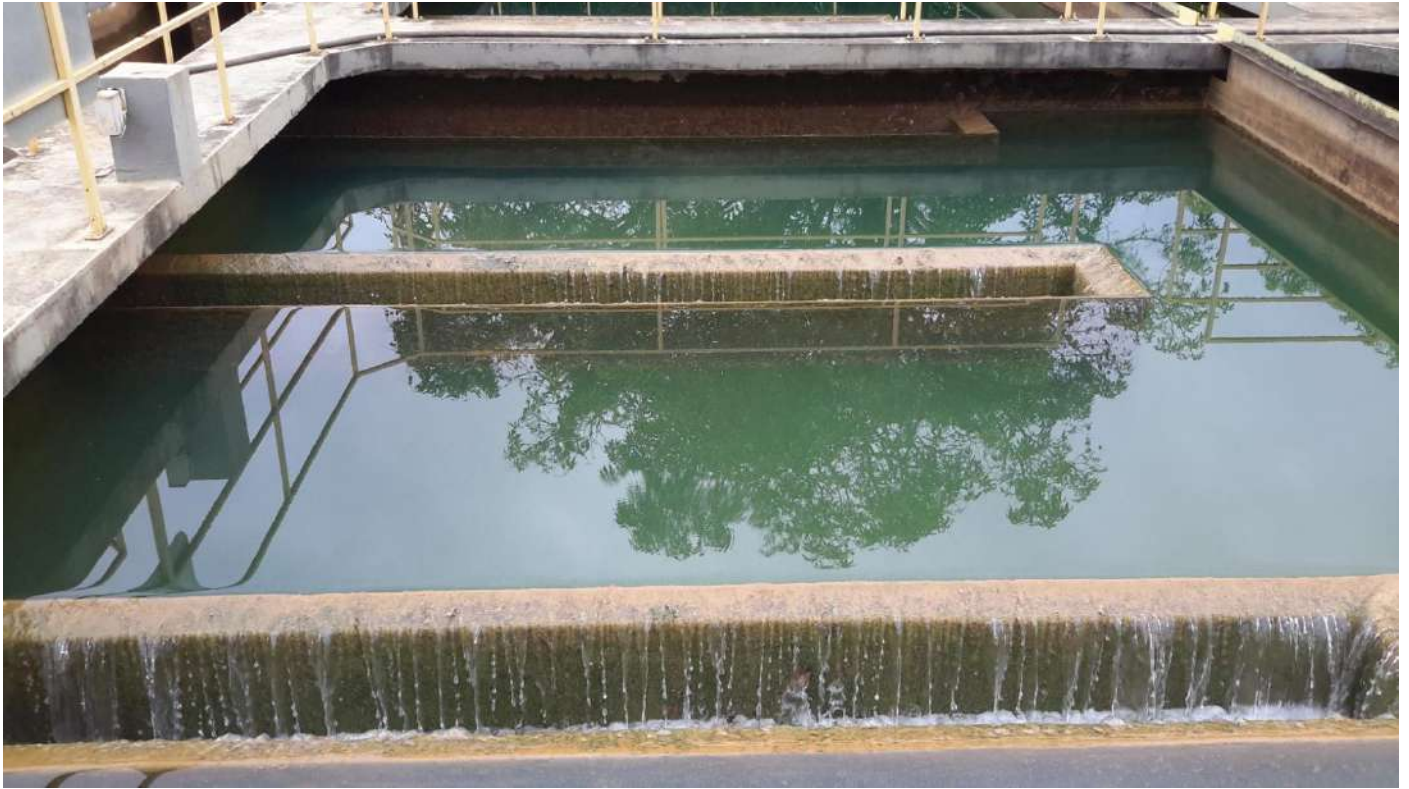
Figura 3: Falta de limpeza da calha recolhadora do decantador.
