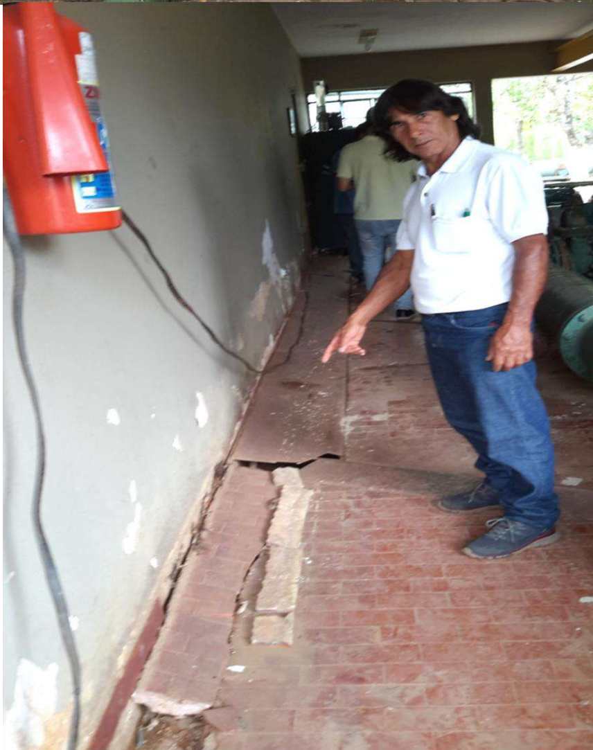
Figura 8: Rachaduras proeminentes na Casa Elevatória de Água Tratada.
