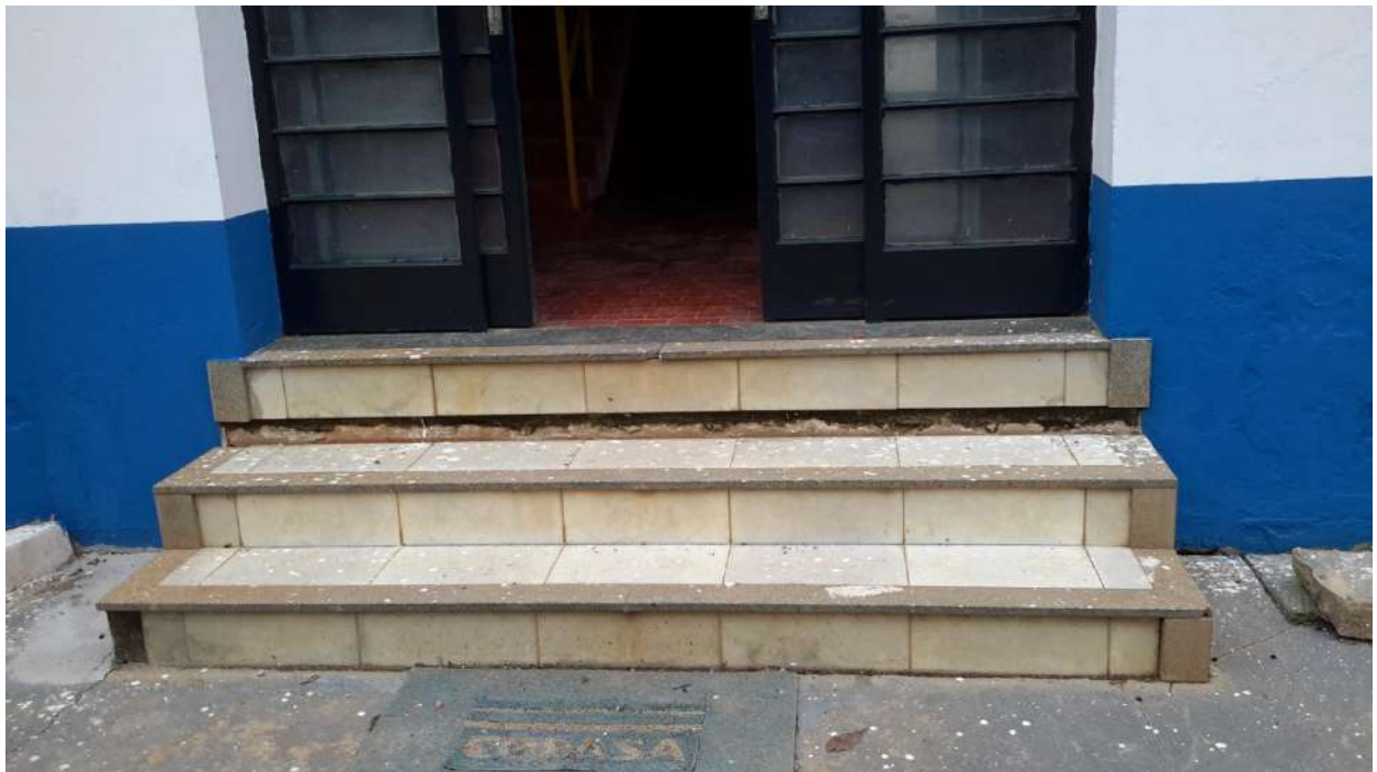
Figura 9: Vista Frontal da Casa Sede da ETA - Peixoto Filho, apresentando um elevado desnivelamento na escada principal.
