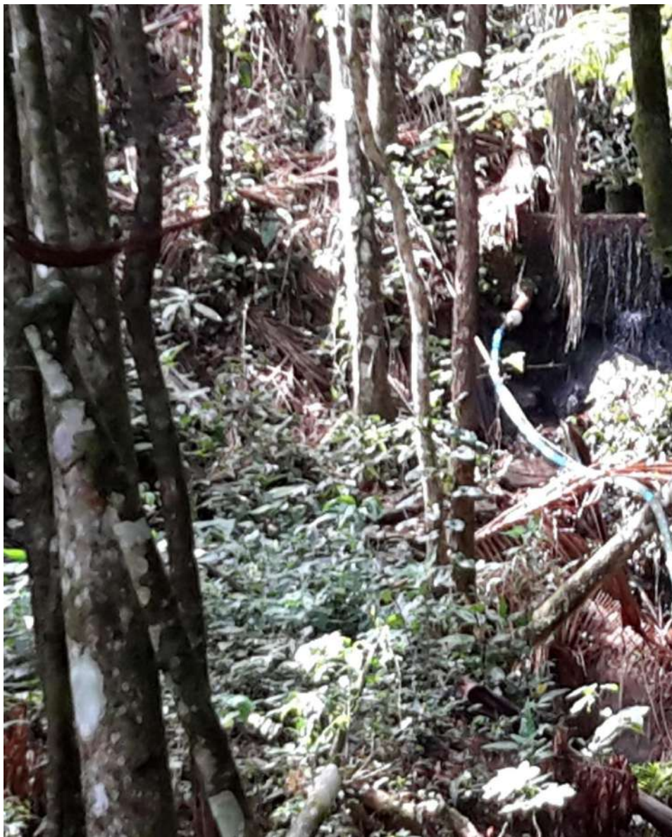
Figura 8: Caixa d'água feita de concreto prendendo o curso d'água, sendo interligada por um cano.
