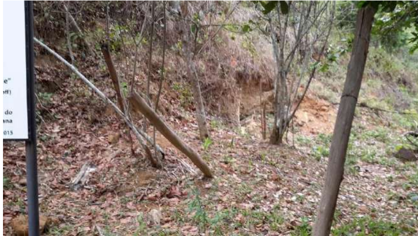
Figura 6: Cerca danificada próxima à "Caixa D'água".
