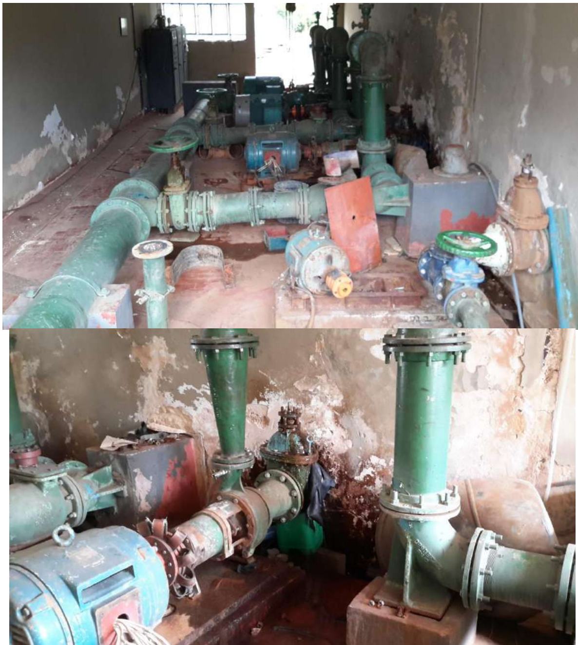
Figura 7: Motores apresentando vazamento.
